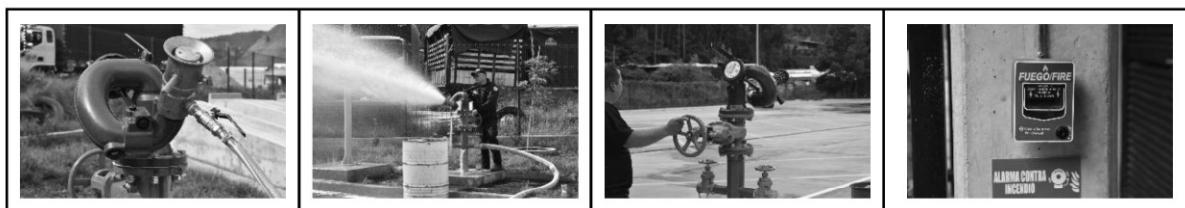
Registro Fotográfico de prueba equipo de incendio Patio Taller Briceño
